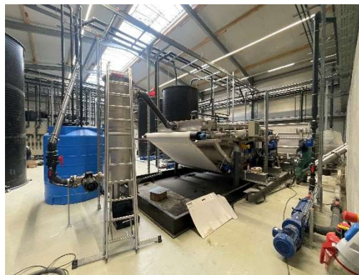
Innenansicht mit Siebbandpresse und Lagertanks
