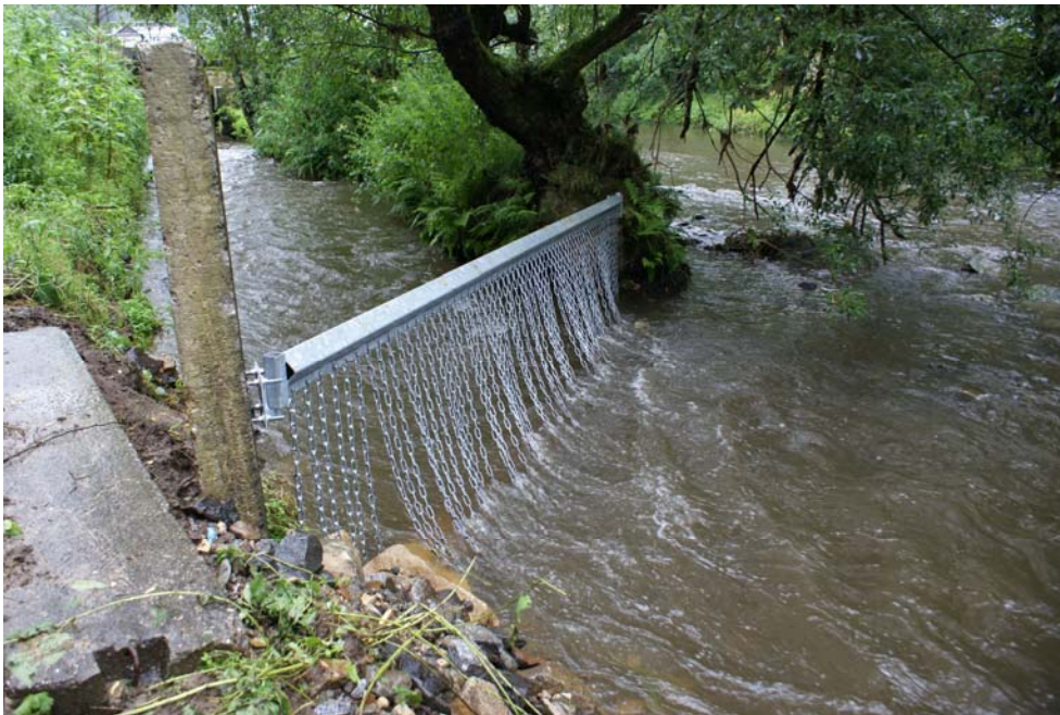
Abb. 5: Einschwimmsperre in Form eines Kettenvorhangs am Auslauf des Turbinenkanals in den Lachsbach
