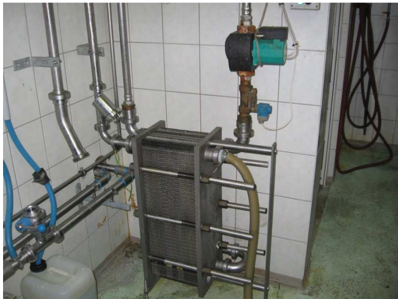
Abbildung 2: Eine Brunnenwasser-Vorkühlung kann den Energiebedarf für die Milchkühlung mehr als halbieren
