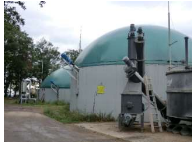
Biogasanlage Adorf mit Wärmenetz
