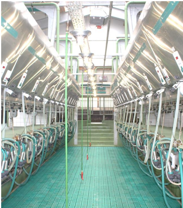
LED-Beleuchtung Melkstand (Leuchtturmveranstaltung Hessen)
