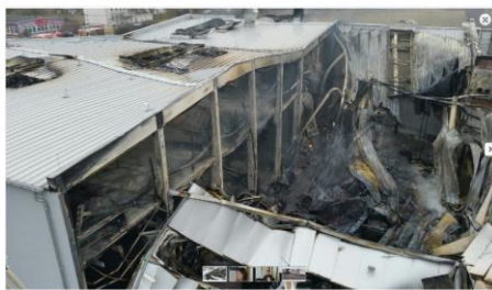
8.2.2017: Störfall in mittelständischem Chemiebetrieb in Edenkoben
